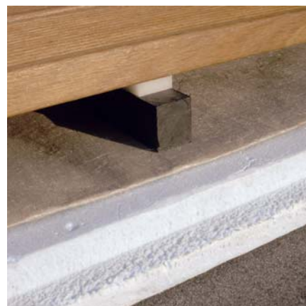
c. geo-włóknina, styrodur / papa lub przeciw-wodna izolacja w „płynie” lub poziomowany grys / podłoże ze spadkiem do 2,5 % (syst. odwrócony) / * → detal nr 02, detal nr 12
