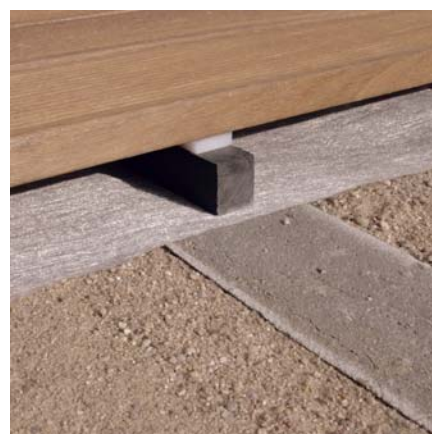
f. pasy betonowe – wylewka pod legarami montażowymi deck-u, spadek 0 – 2,5 % / ziemia / zalecana geo-włóknina
